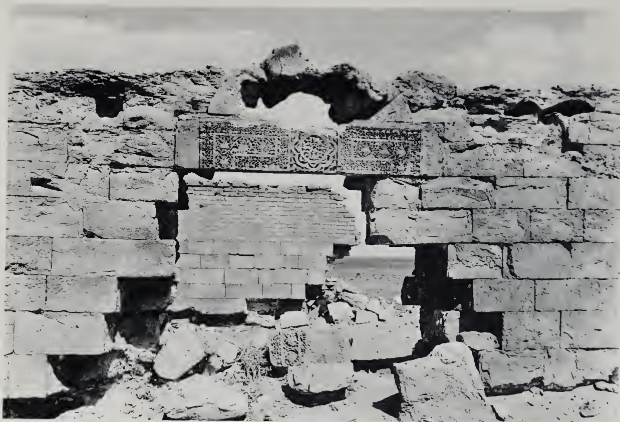
1. — QASR ET-TÛBA. — Chambre B. — Porte ruinée sur le côté Est, et face intérieure du mur occidental.
